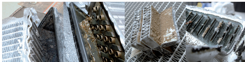
Figure 2 : Les dépôts tels que la rouille, le calcaire, les produits d'étanchéité ou d'autres corps étrangers provoquent des colmatages et réduisent la performance frigorifique
